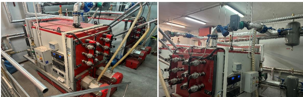
Kotłownia w budynku Zespołu Szkół Publicznych w Kaliskach
