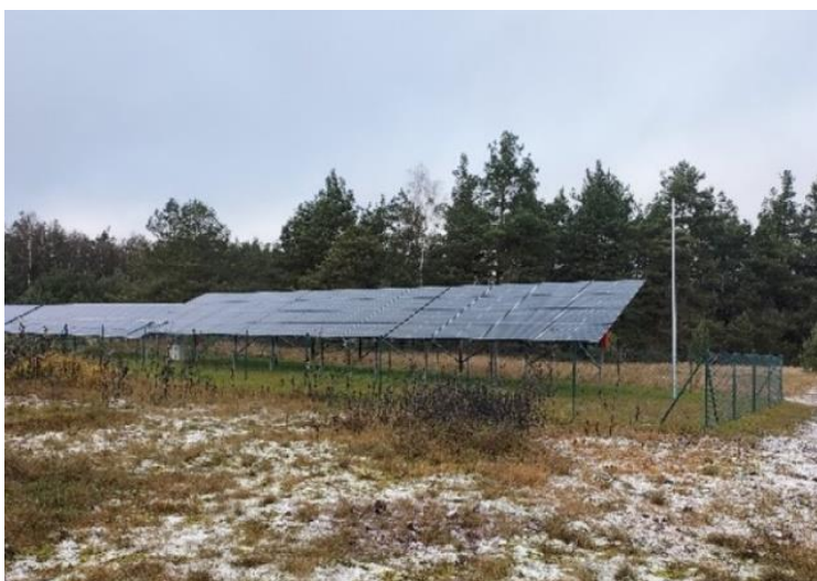
Rozbudowana instalacja fotowoltaiczna
