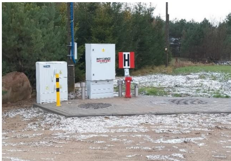
Przepompownia sieciowa przy ul. Osiedle Leśne w Dąbrowie
